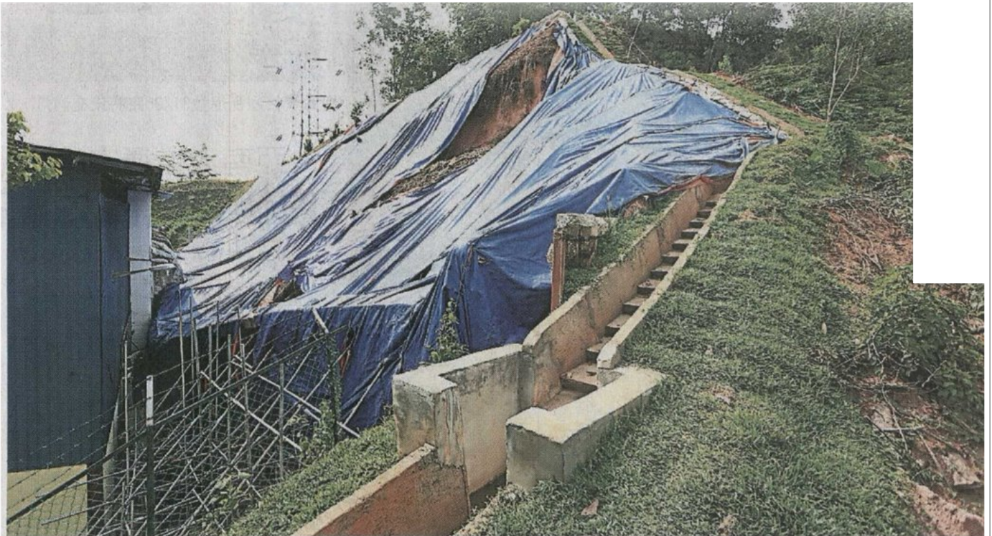
▲ 为了避免雨水侵蚀造成泥土再流失，士拉央市议会在坍塌的围墙上覆盖一大片的塑料防水布。
