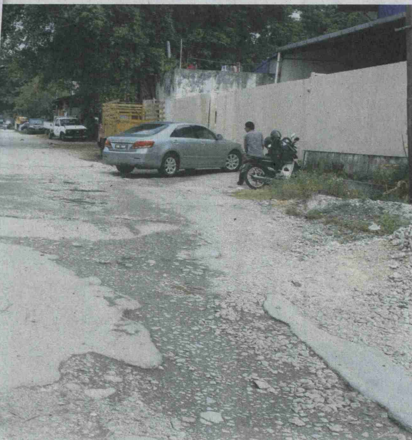
PERMUKAAN jalan rosak teruk disebabkan kegagalan pihak berkuasa tempatan menjalankan kerja-kerja penyelenggaraan.
